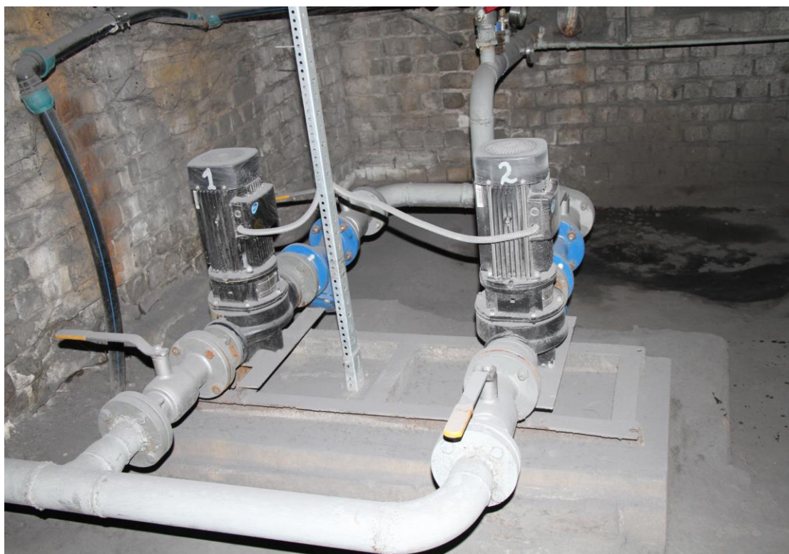
Насосная группа котельной состоит из двух циркуляционн ых насосов Grundfos TR 32-320/2.
