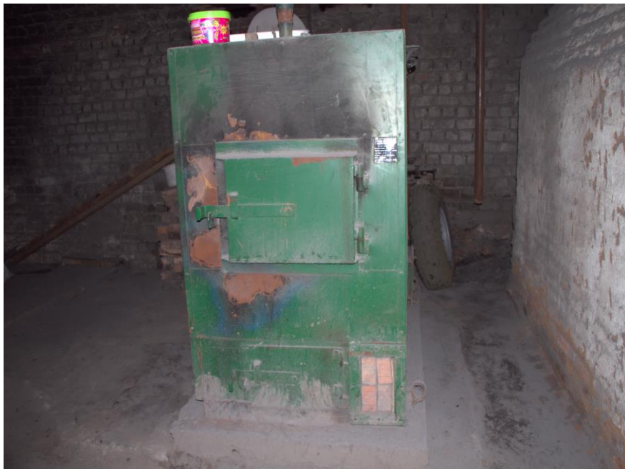
Внешний вид резервного котла КВР
